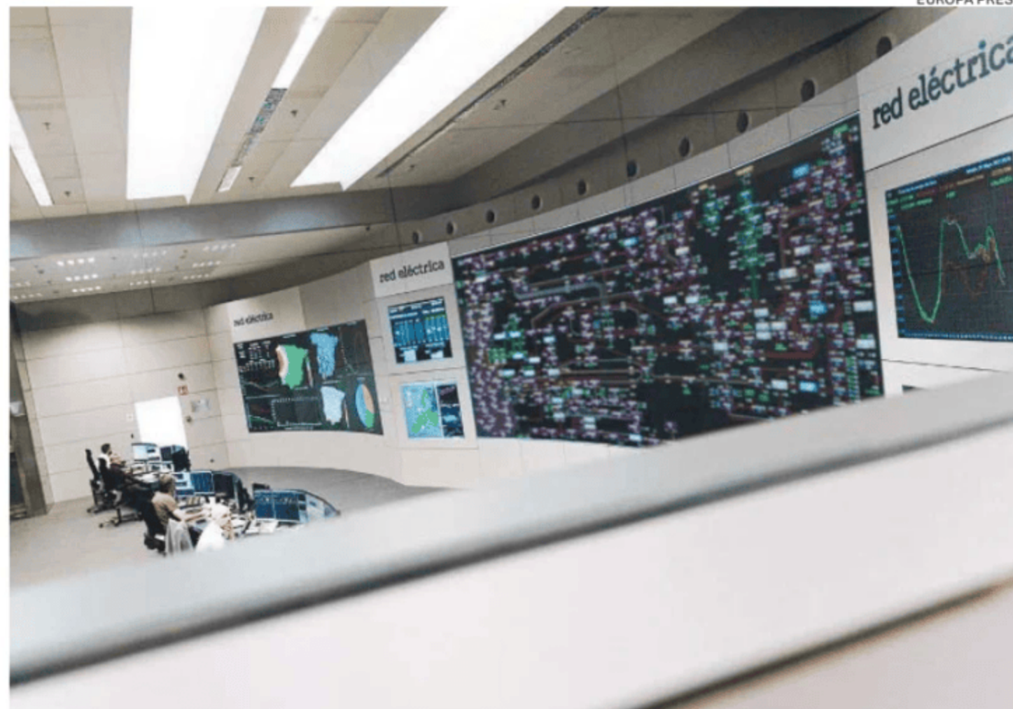
Los criterios de protección del sistema peninsular son de 1996. En la imagen, la sala de control de Redeia
